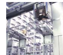
Sistemas automatizados de manipulación de materiales (AMHS) para salas limpias -AMHS para fab. de semiconductores -MCS (sistemas de control de materiales)
