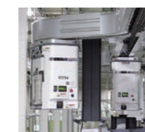
Sistemas automatizados de manuseamento de material para salas limpas -AMHS para fabrico de semicondutores -MCS (sistemas de controlo de materiais)
