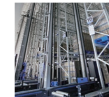
Lojistik Sistemleri / Fabrika Otomasyon Sistemleri -Otomatik Depolama ve Geri alma Sistemleri (AS/RS) (Automated Storage & Retrieval Systems) -Sıralama Sistemi
