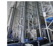
Logistiksysteme/ Fabrikautomatisierungssysteme - Automatisierte Lager- und Bereitstellungssysteme (AS/RS) - Sortiersystem
